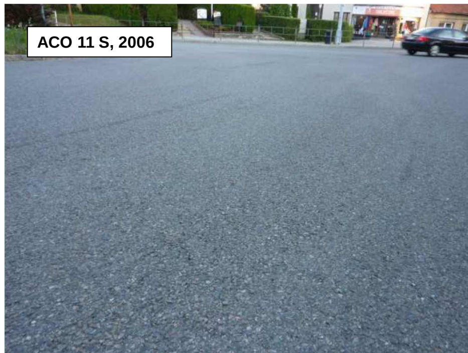
Obrus krytu, přecházející do hloubkové koroze
