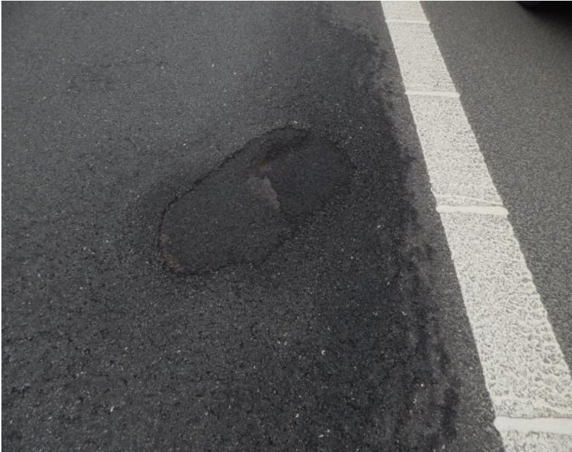
Destrukce obrusné vrstvy
