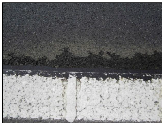
Obrázek 2: Boule na mostní vozovce
