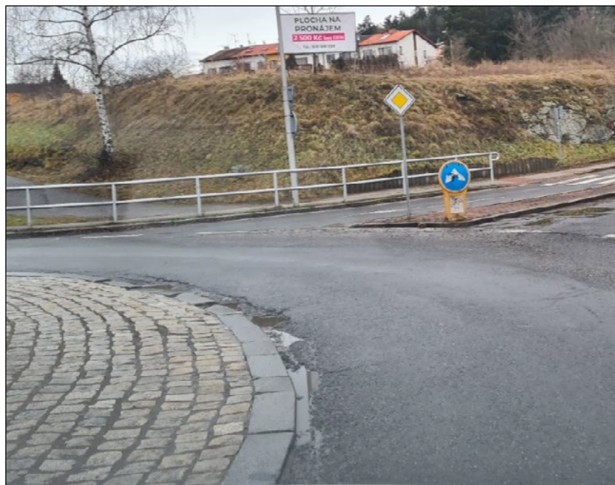
Obrázek 2: Poruchy na styku prstence a vozovky
