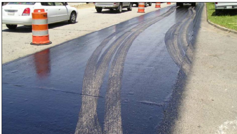
Obrázek 2: Častým problémem na staveništi jsou pojezdy těžké staveništní techniky po spojovacím postřiku
