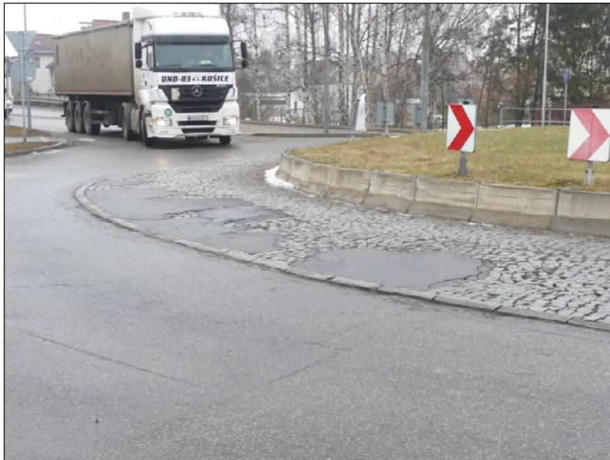
Obrázek 1: Poruchy nevhodně navrženého středového prstence z drobných kostek
