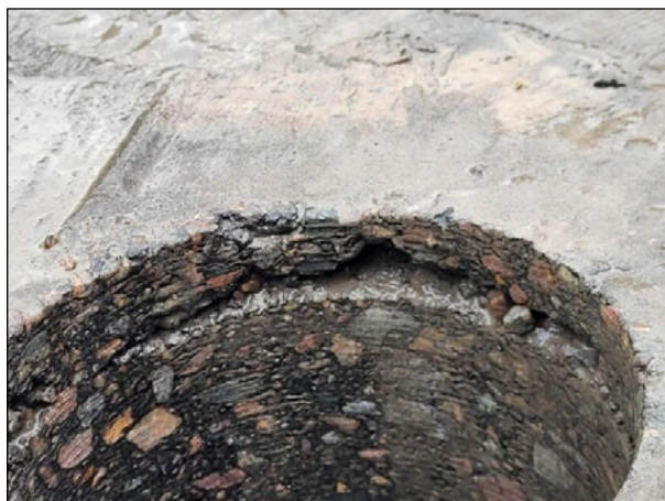
Obrázek 7: Kaverna po rozpadlé asfaltové vrstvě
