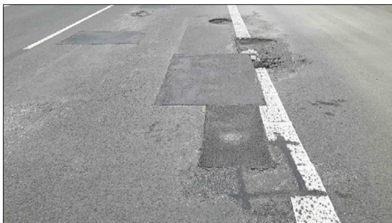
Obrázek 5: Opravy výměnou asfaltového krytu jsou neúčinné
