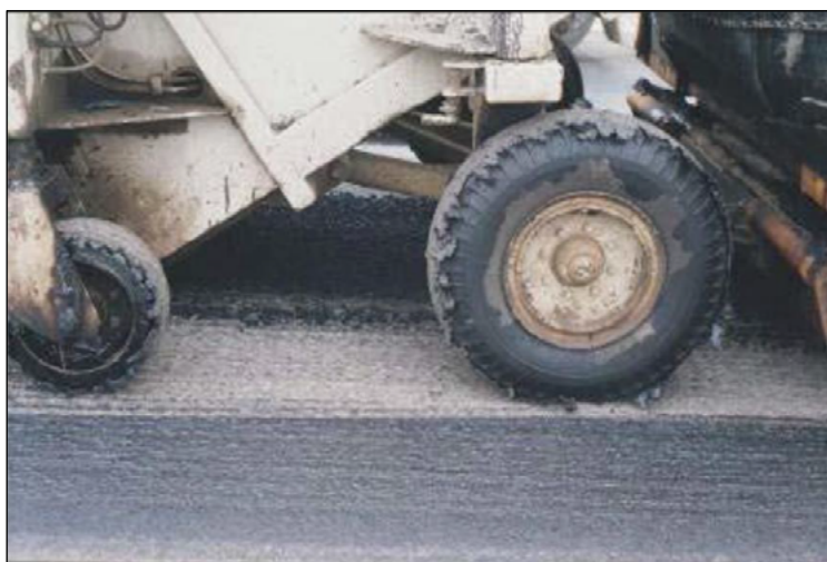
Obrázek 3: Častým problémem na staveništi jsou pojezdy těžké staveništní techniky po spojovacím postřiku
