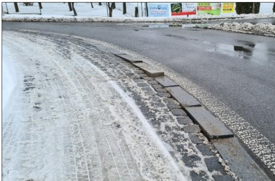
Obrázek 3: Poruchy nevhodných obrub na styku prstence a vozovky
