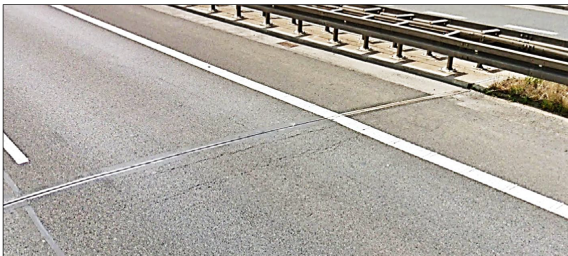
Obrázek 11: Charakteristické poruchy v okolí mostního závěru na přechodové desce
