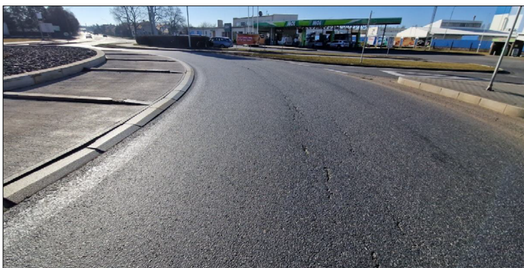
Obrázek 6: Poruchy obrub a vozovky jízdního pásu
