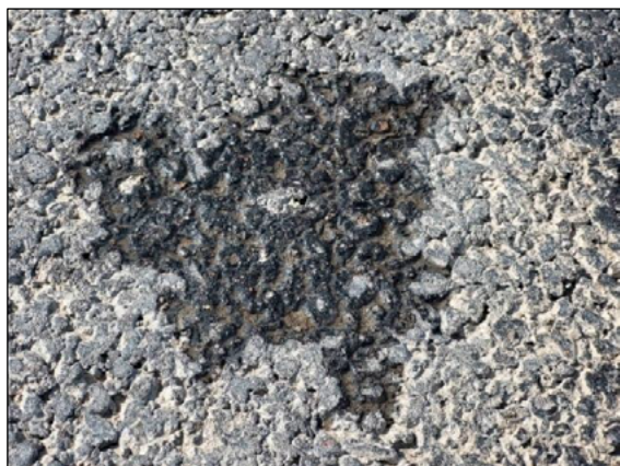
Obrázek 1: Výrony vody na mostní vozovce
